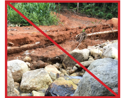
Đường thiết kế sát sông suối, nguy cơ sạt lở, xói mòn và ảnh hưởng chất lượng nguồn nước
